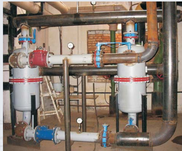
Теплообменные аппараты ТА8-8Р-2 для горячего водоснабжения. Мощность 1750 кВт, P_{\text{раб.}} = 0,8 \text{ МПа}
