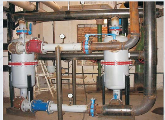
Теплообменные аппараты ТА8-8Р-2 для горячего водоснабжения. Мощность 1750 кВт, P_{\text{раб.}} = 0,8 \text{ МПа}
